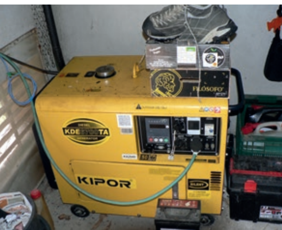
>> Generador de gasoil de suport a l'energia solar de la casa del Plantadís, que funciona autònomament.
