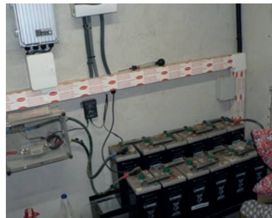
>> Joc de bateries que acumulen l'energia generada per les plaques solars a la casa del Plantadís.
