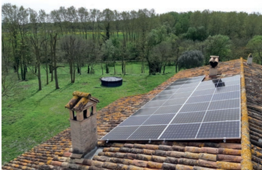
>> Plaques solars instal·lades en un habitatge de Cornellà del Terri. (Foto: NUCLI SOLAR)
