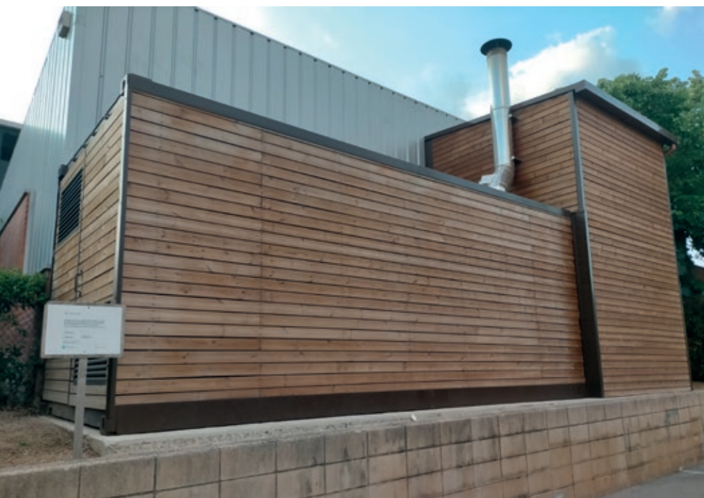
>> La caldera de biomassa que hi ha instal·lada en un annex del pavelló de Serinyà i que permet escalfar el pavelló mateix, l'Ajuntament, l'escola i la llar d'infants. (Foto: SÒNIA TUBERT)
