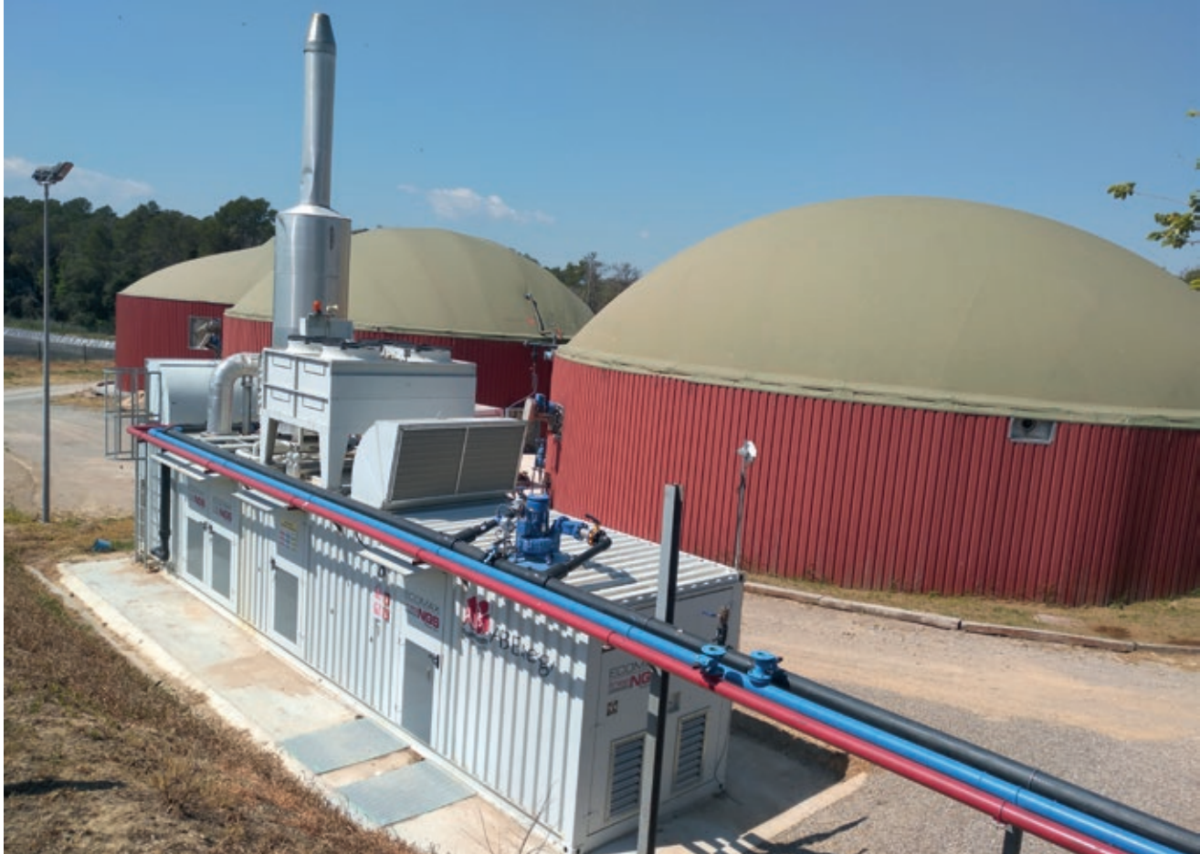
>> Planta de biogàs situada a l'explotació ramadera SAT Sant Mer, de Sant Esteve de Guialbes, el 2017. (Foto: APERGAS)
