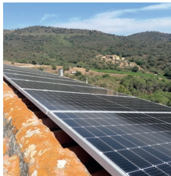
>> Plaques solars instal·lades a Vilamaniscle. (Foto: NUCLI SOLAR)
