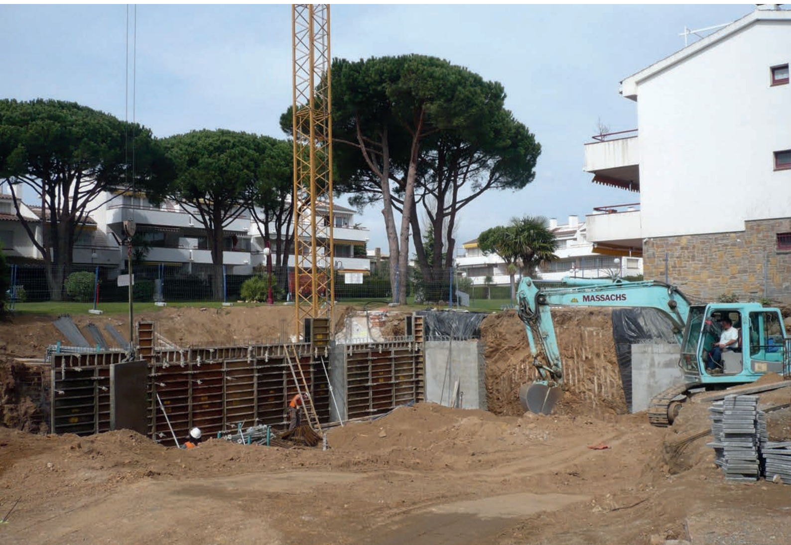
>> Obres de construcció, el 2008, del nou edifici que havia de suplir el que es va haver d'enderrocar per sentència judicial, al Calella Park. El cost el va assumir l'Ajuntament de Palafrugell. (Foto: AJUNTAMENT DE GIRONA. CRDI. FONS EL PUNT. ALBERT VILAR MASSÓ.)
