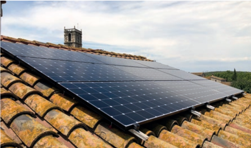
>> Instal·lació de plaques solars en una masia d'Orfes. (Foto: ELECTROFLUXE)
