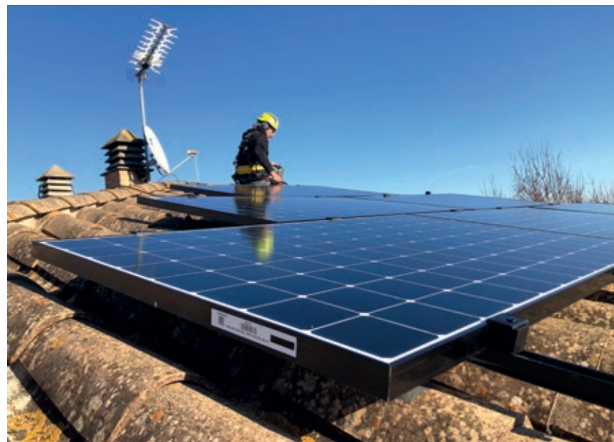
>> Instal·lació de plaques solars a Banyoles. (Foto: ELECTROFLUXE)
