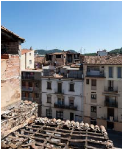
>> Cases en procés de restauració al nucli antic d'Olot. (Foto: QUIM ROCA)
