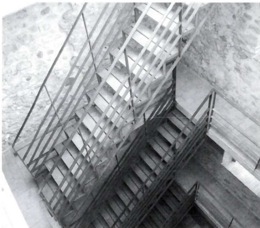
Interior de la torre un cop restaurada, amb els tres nivells de pas recuperats, que alhora serveixen per lligar el conjunt i donar-li solidesa.
