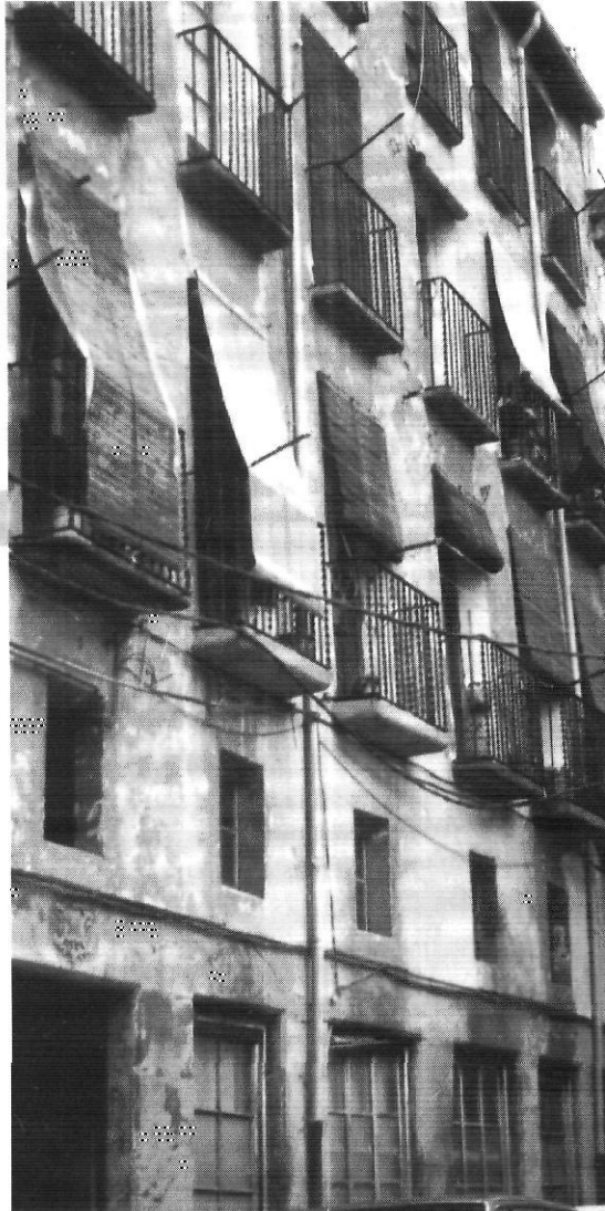
Façanes de les Cases d'en Bach, de les quals en perilla la seva conservació.
