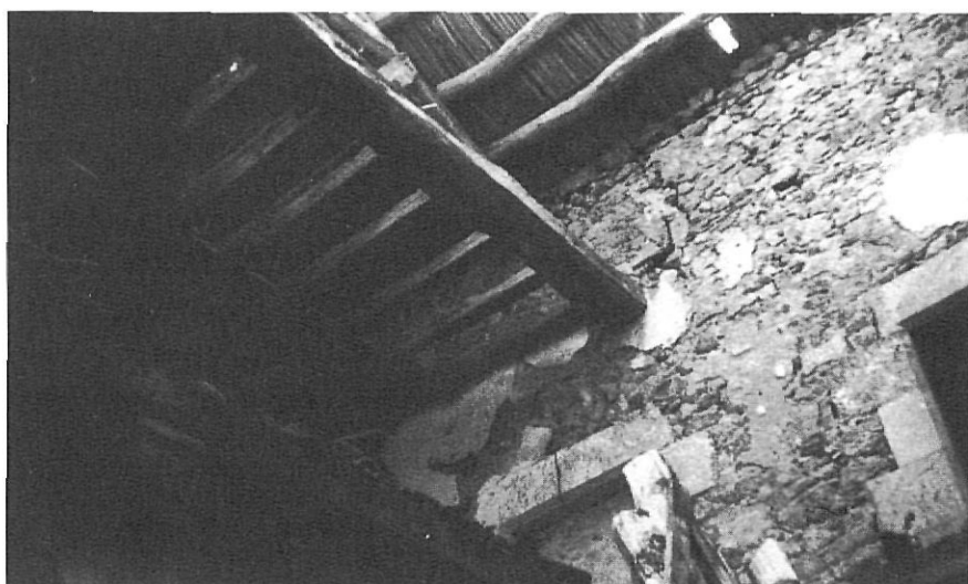
Diversos aspectes de l'estat de l'edifici.
