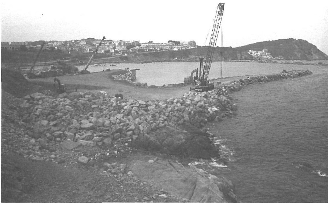
El port de Sota Padró, a Palamós, és l'únic projecte que ja es troba en fase d'execució.
