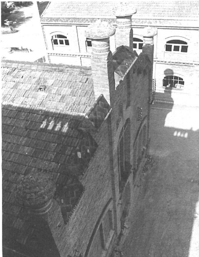
Visió des de dalt de la façana posterior de la sala de màquines.
