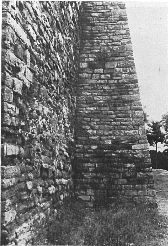
PALMEROLA. — Contrafuerte de contrarresto del desplome en el muro poniente. Obra del Patrimonio Artístico Nacional
