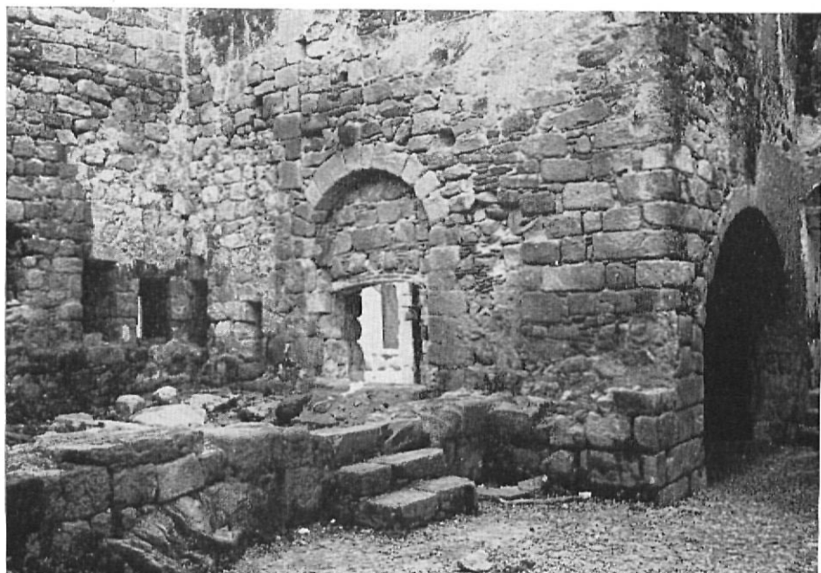
CASTELL D'ARO. — Castillo en restauración. Excavaciones al pie han podido descubrir las estructuras hasta sus cimientos y asientos encima la roca natural, granito rosado en proceso de descomposición. (Fot Luis Esteva)
