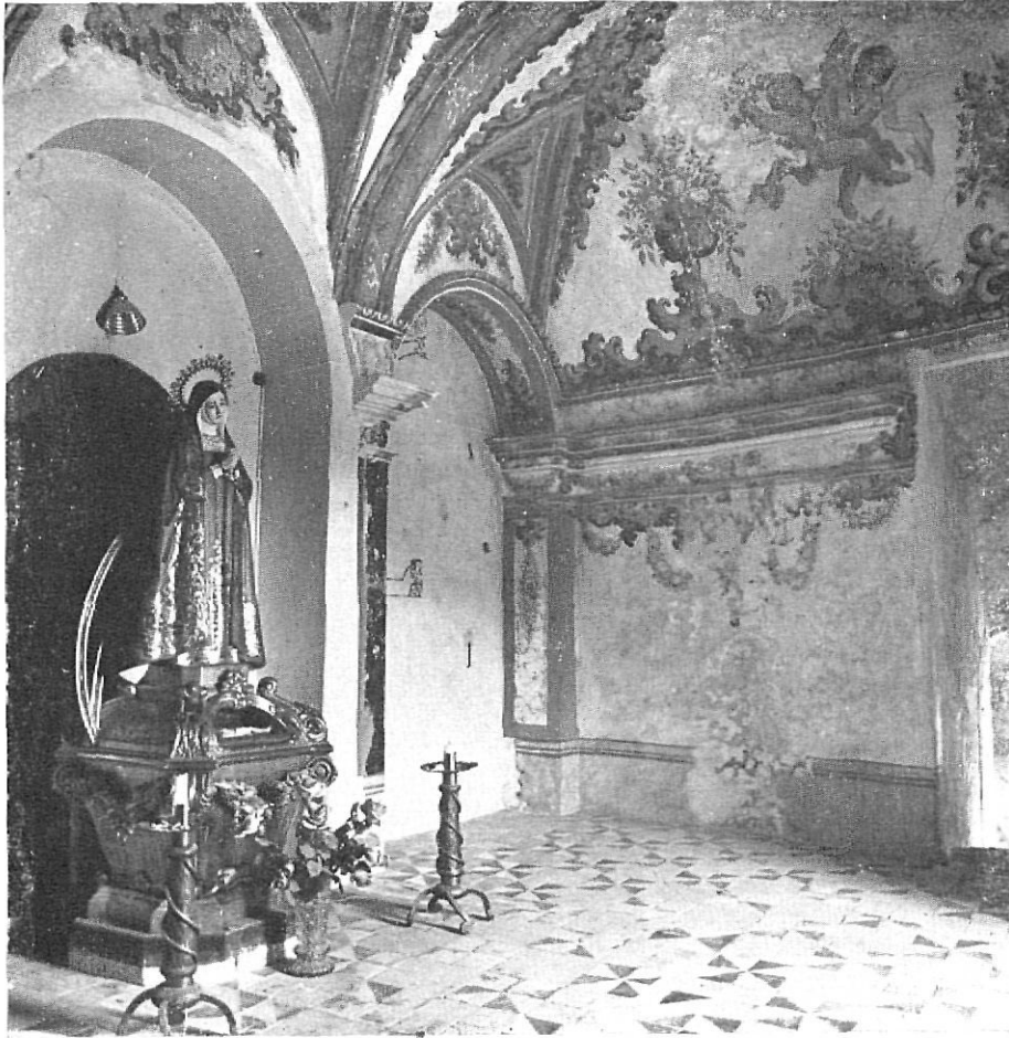
SANTA PAU. — Santuari dels Arcs. Camarin de la Virgen. Pinturas murales barrocas e imagen moderna de la patrona titular del santuario. El camarín ha sido derribado en 1970, para proseguir la obra de restauración de la fábrica del templo.
