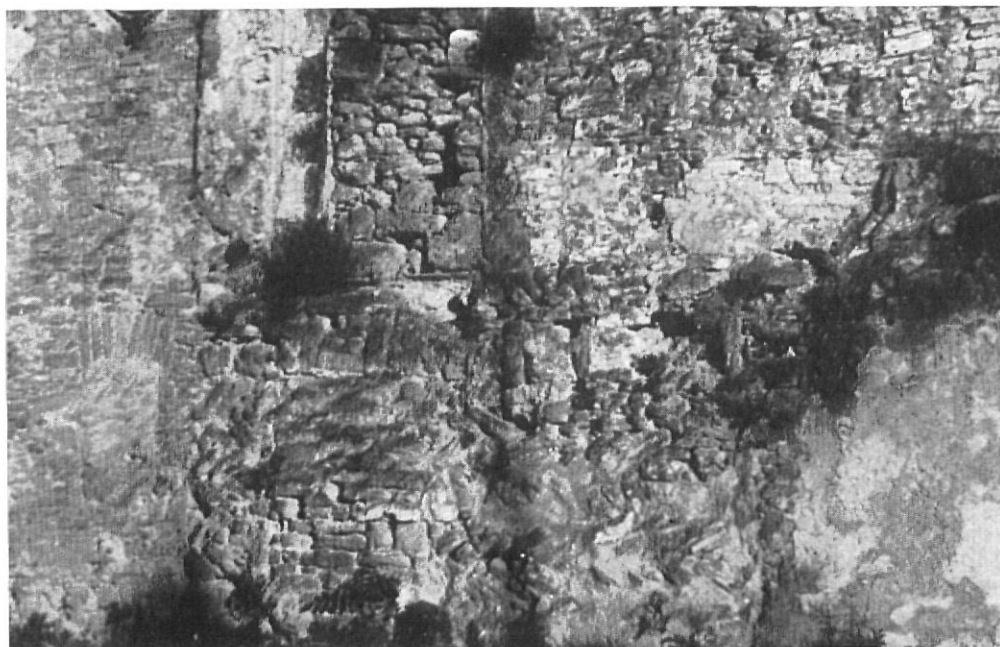
Primitiva estructura de OPUS SPICATUM en el muro Norte de Casa Misión.
